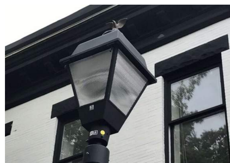
Pedestrian Lighting / Iluminación Peatonal
